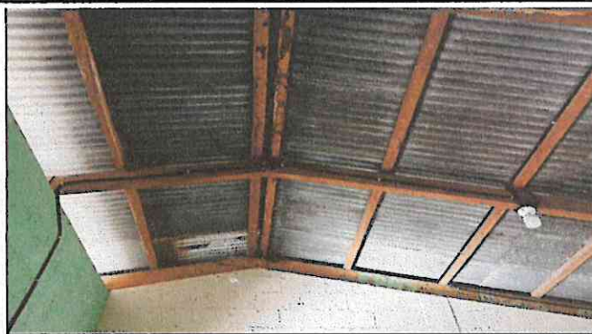
Foto 2: Interior de aula con estructura de madera y lamina en mal estado
