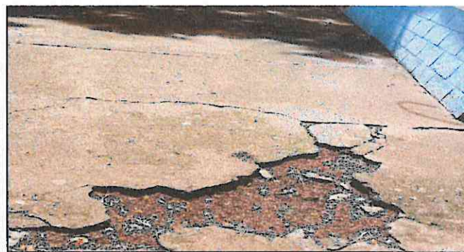
Foto 6: Losa de patio en mal estado
