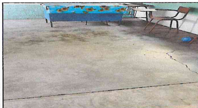
Foto 3: Interior de 3 aulas con piso en mal estado.
