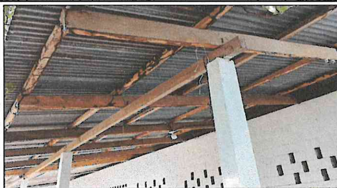
Foto 1: Corredor de aula con estructura de madera y lamina en mal estado.
