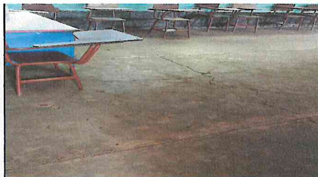
Foto 4: Interior de 3 aulas con piso en mal estado.
