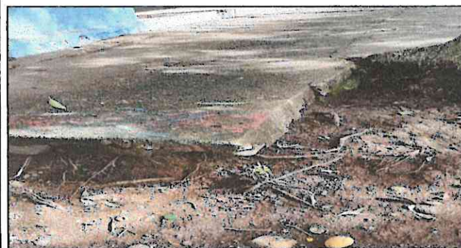
Foto 5: Losa de patio en mal estado
